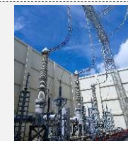
志賀中能登線ケーブル 接続状態
