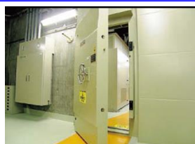
水密扉の設置
