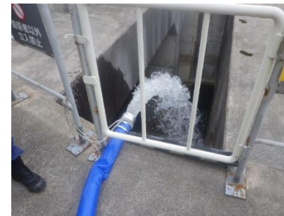
④ 海水の放水
