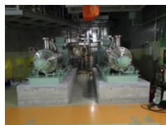
常設代替低圧ポンプの設置
