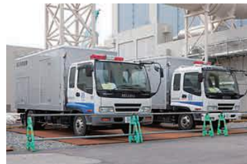
高圧電源車 [300kVA] (1号機用：2台、2号機用：3台、予備1台)
