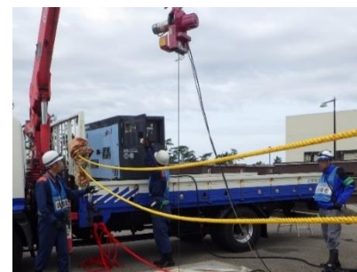
③ ディーゼル発電機操作 (水中ポンプ起動)
