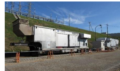
大容量電源車 [4,000kVA] (1号機用：1台、2号機用：1台)
